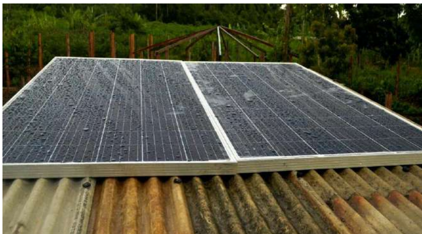
Imagem: placas solares após lavagem
